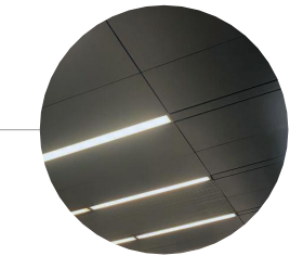
Встроенная линейная подсветка потолка
